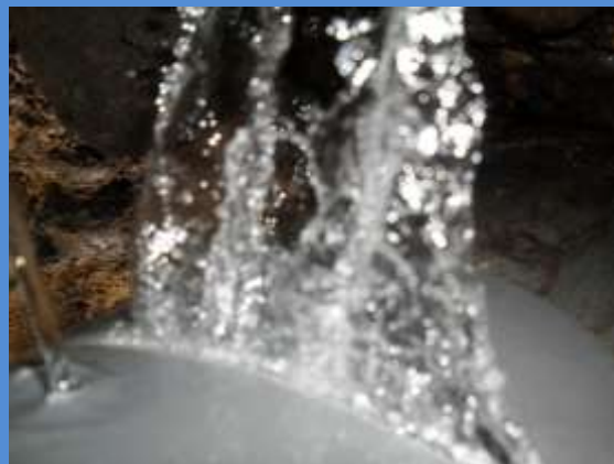
Actual leak detected
